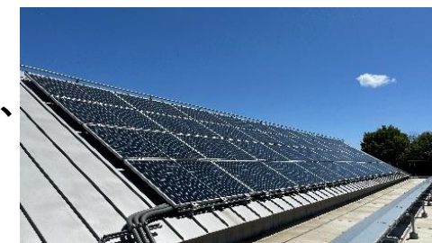
都立学校屋上の太陽光発電設備
