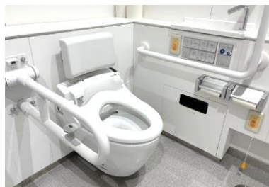
都立学校のバリアフリートイレ
