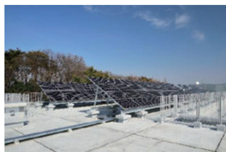
太陽光パネルを設置した例
