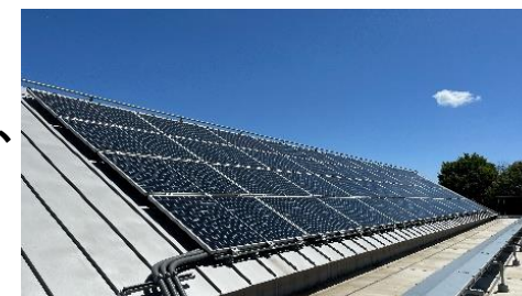
都立学校屋上の太陽光発電設備
