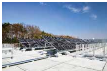
太陽光パネルを設置した例
