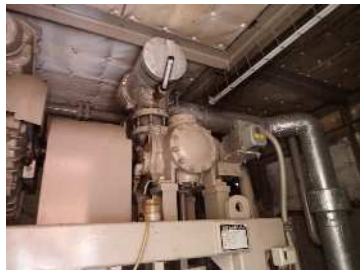
③機器内部
