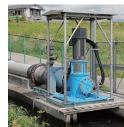
農業用水路活用 水力発電設備
