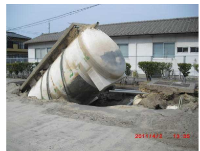
液状化で地中から表れた浄化槽
