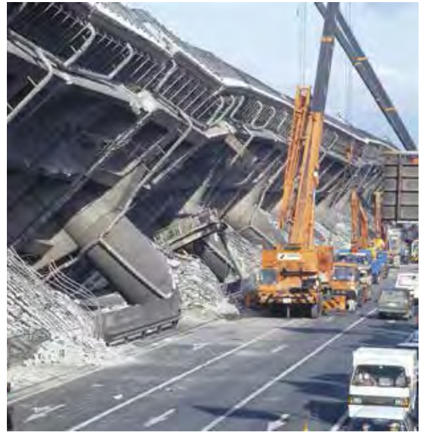
橋脚からなぎ倒された高速道路 [阪神・淡路大震災 平成7年(1995)1月]
